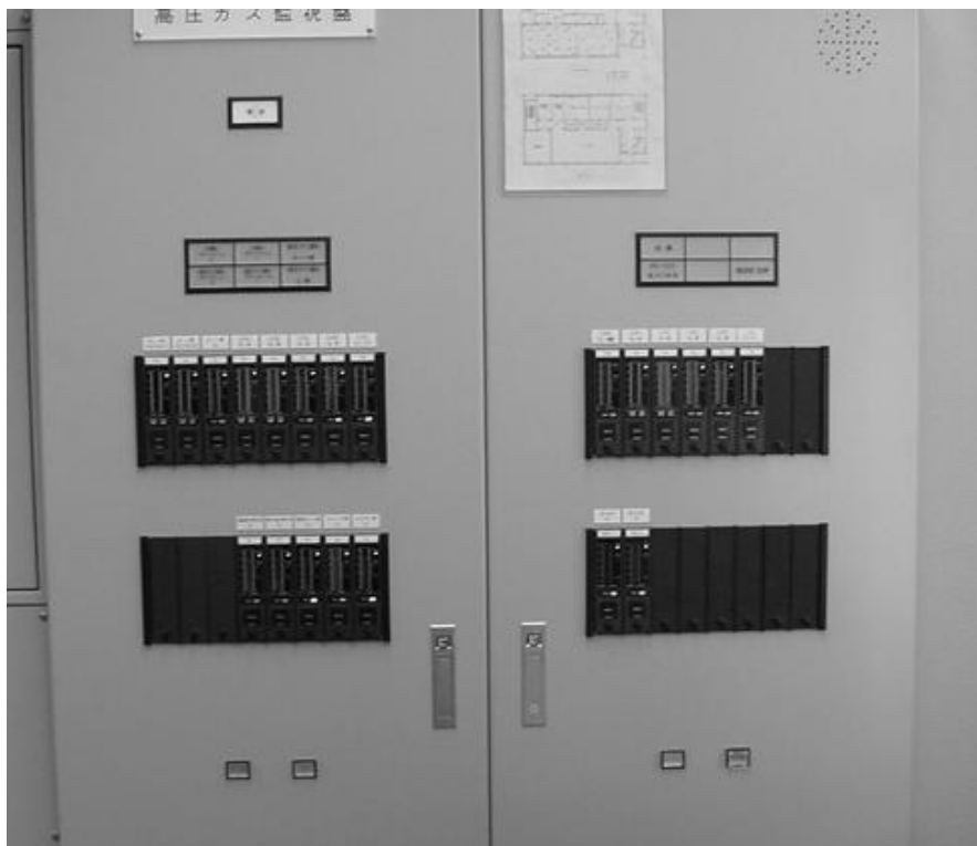
高圧ガス監視盤（解析室）
