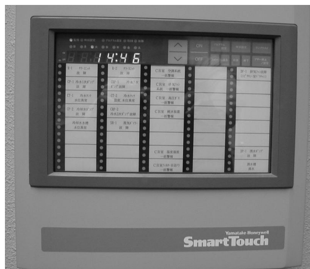
空調監視盤（開発室）
